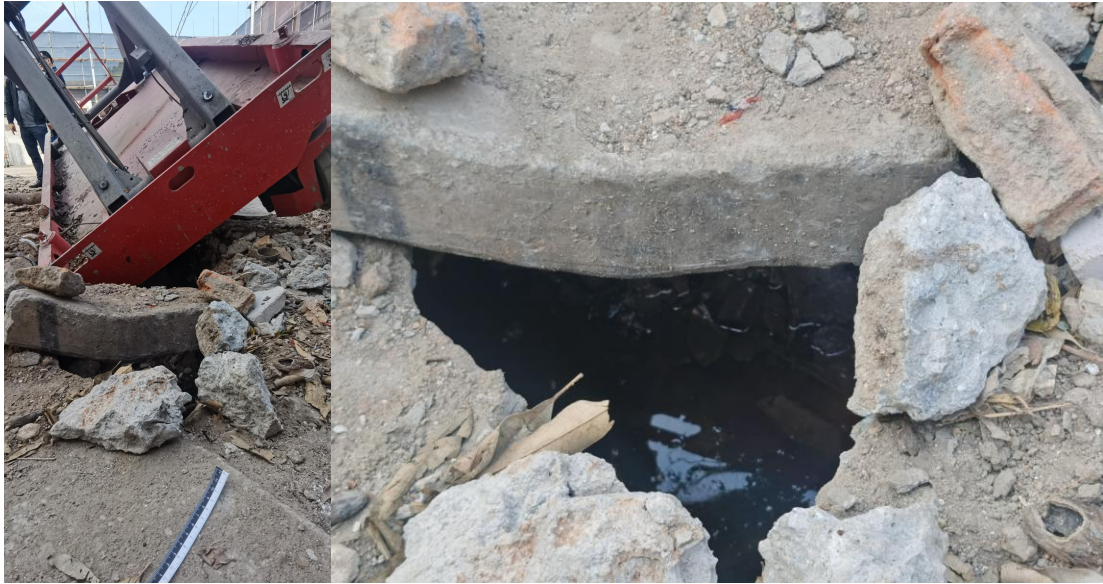
图 11、12 涉事 SPS1012HA 剪叉式高空作业平台下陷一侧为化粪池
