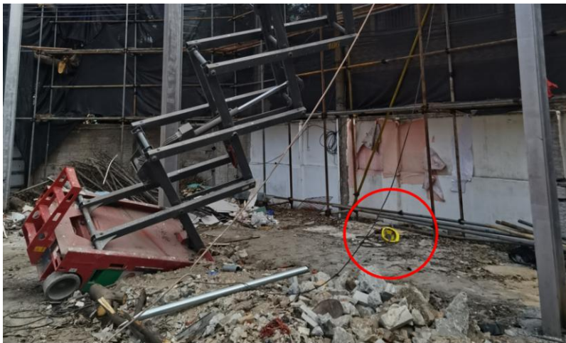
图 13 凌某某的安全帽掉落在距离坠落位置约 2m 外
