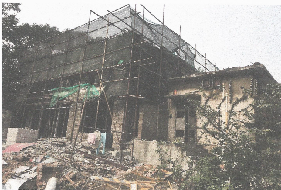
(2019年1月18日, 鹤洞路265号涉嫌改建、扩建建筑现场)
