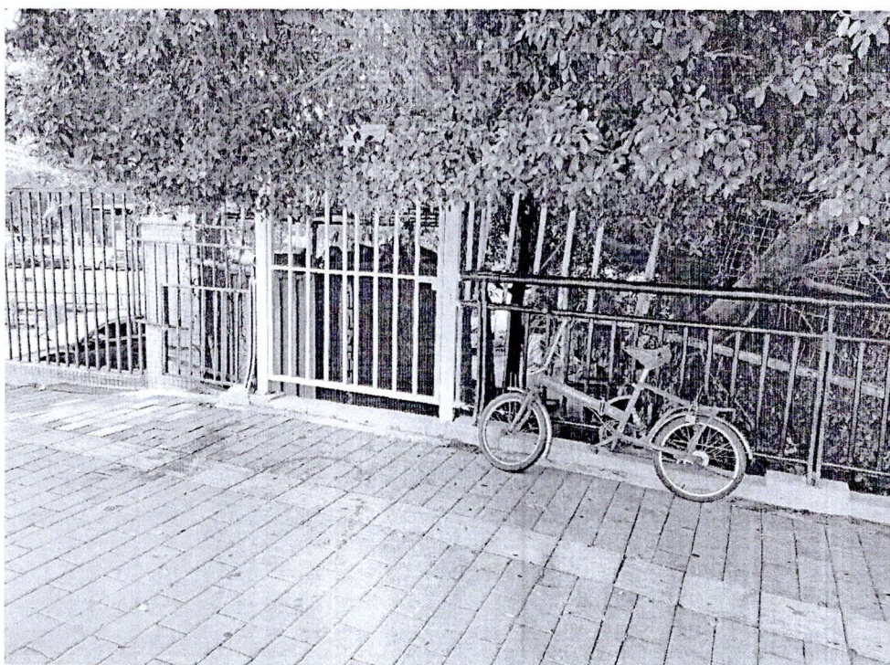
图 4 芳盈路跨涌桥右侧围栏已设置电子门禁
